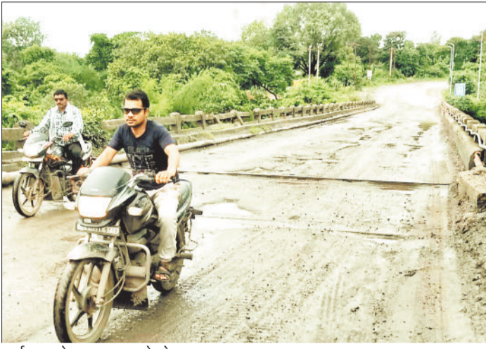
जर्जर पुल से आवागमन करते लोग।
